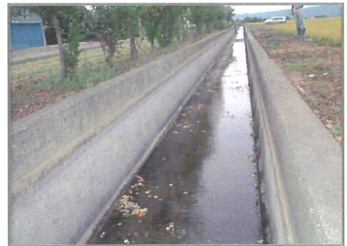
美唄貝沼幹線用水路補修前
