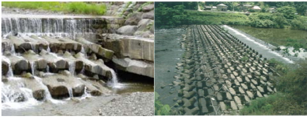
写真-2 落差工下流に設置された護床エブロック
