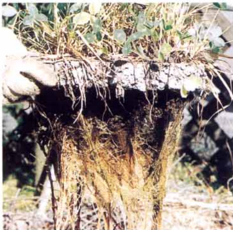
ポーラスコンクリートを貫通した植物の根
